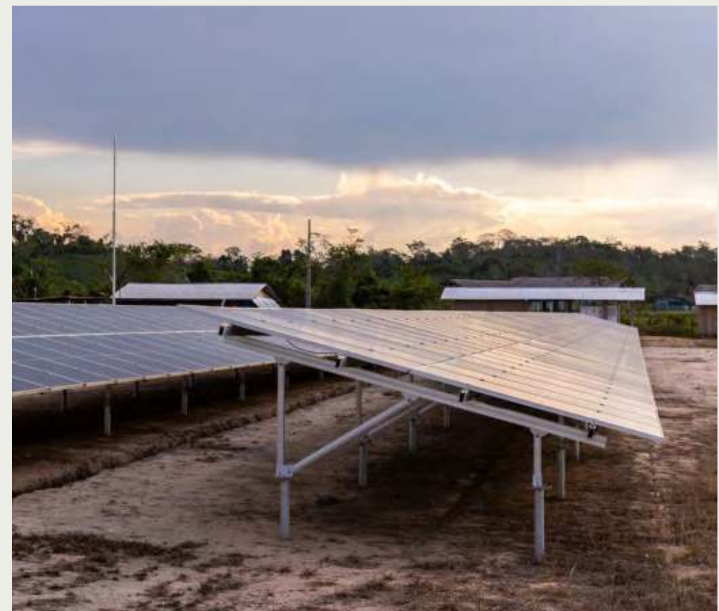
Planta de energía solar en Puerto Esperanza, Purús.
