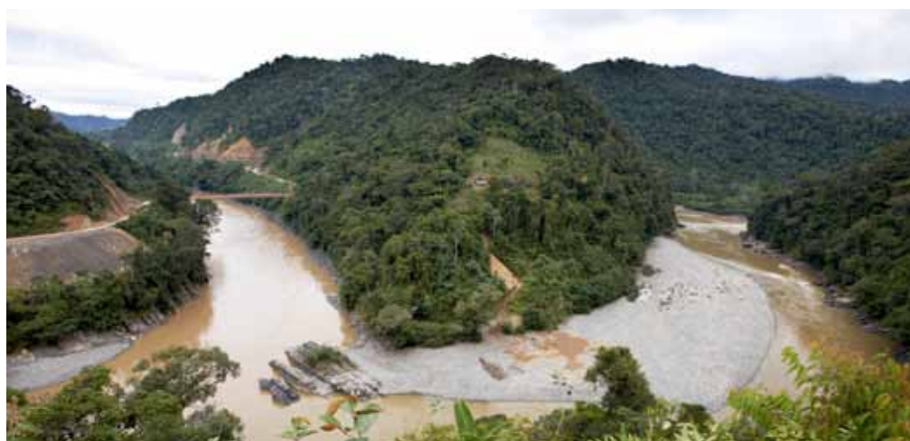
Este es el punto exacto del lugar de construcción del dique. Aquí confluyen los ríos Inambari (que llega por la izquierda) y el Araza (que llega por la derecha).
